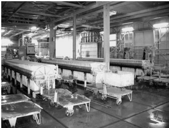
図-3 フィルタープレス（製土工程）
